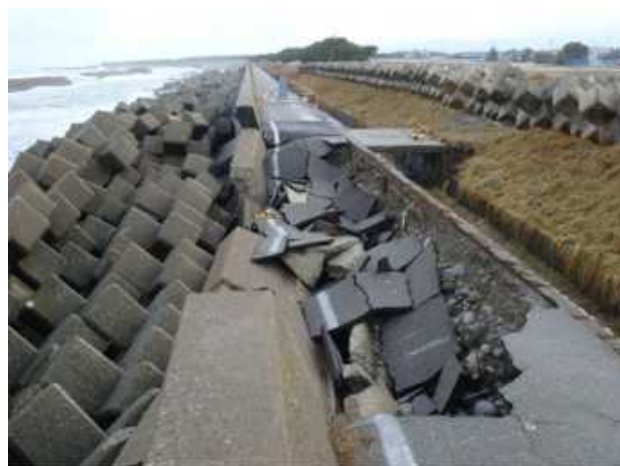
直立堤の被災状況(五十里地区)(平成20年2月)
