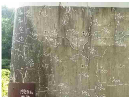
損傷状況 橋脚のひび割れ
