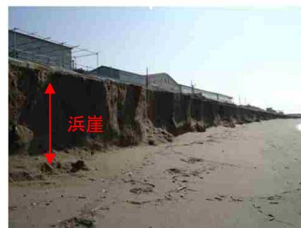
金衛町工区被災状況(平成18年9月)
