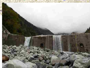
本堤水通し天端摩耗
