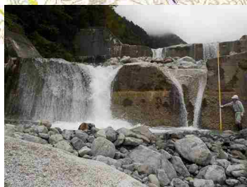
副堤水通し天端摩耗
