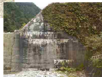
本堤遊離石灰・ひび割れ
