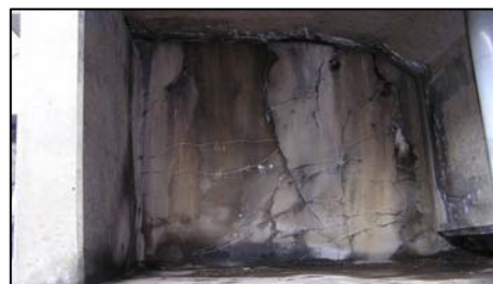
橋台のひび割れ
