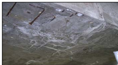
主桁の剥離・鉄筋露出
