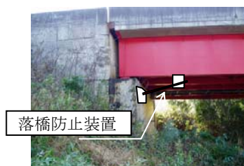
落橋防止装置設置箇所
