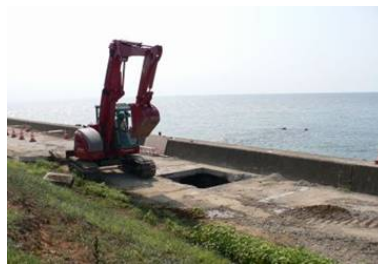
平成20年8月 空洞箇所の状況
