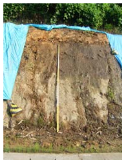
法面湧水の状況
