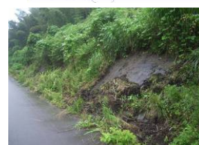
法面小崩落の状況
