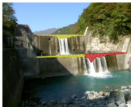
大所第1号砂防えん堤天端損傷状況
