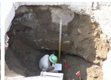
平成20年8月 空洞箇所の状況
