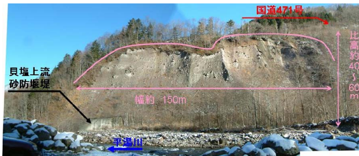
貝塩地先の法面崩壊全景
