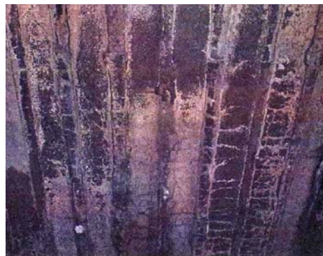
【梁部ひび割れ】
