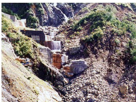
H4年の出水による柳谷第3号、第6号砂防えん堤の被災状況
