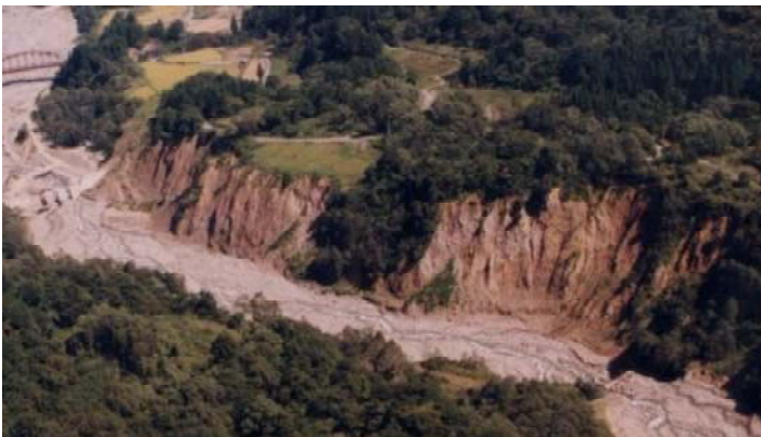
浦川の溪岸斜面の崩壊状況
