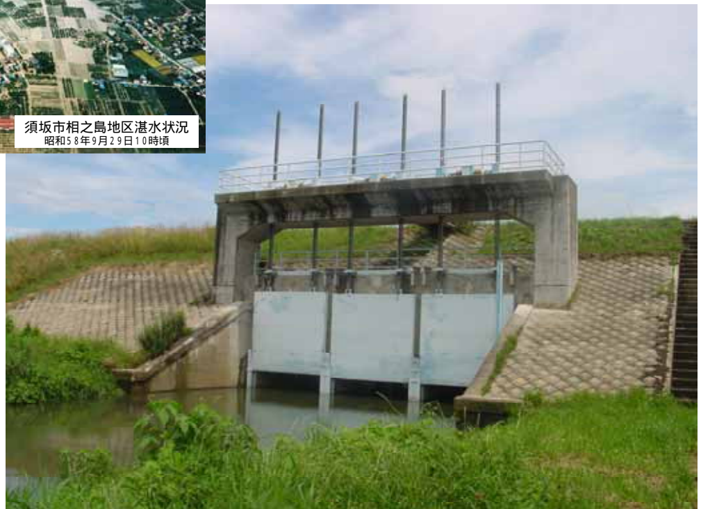
老朽化が進んでいる百々川樋門
