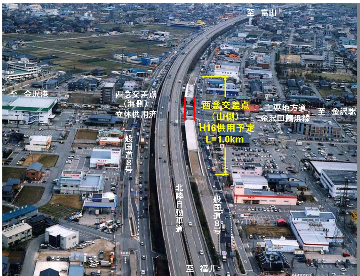
平成 16 年度の供用に向け工事の進む西念交差点立体化 ( 福井方向から富山方向を望む )
