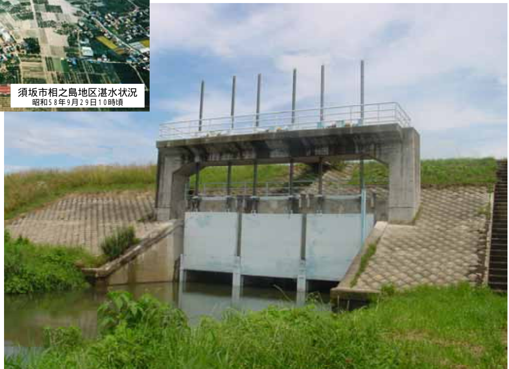
老朽化が進んでいる百々川樋門
