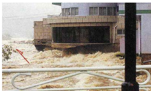
H10.9出水被災状況（マンション基礎洗掘）
