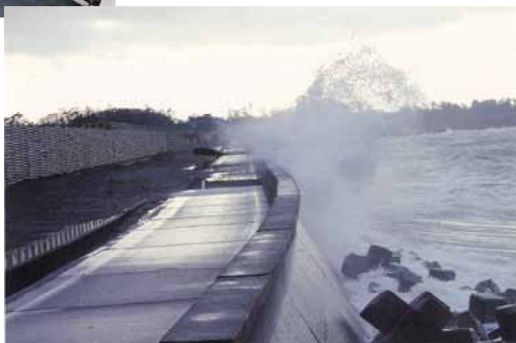
片山津海岸での越波状況（平成14年1月）
