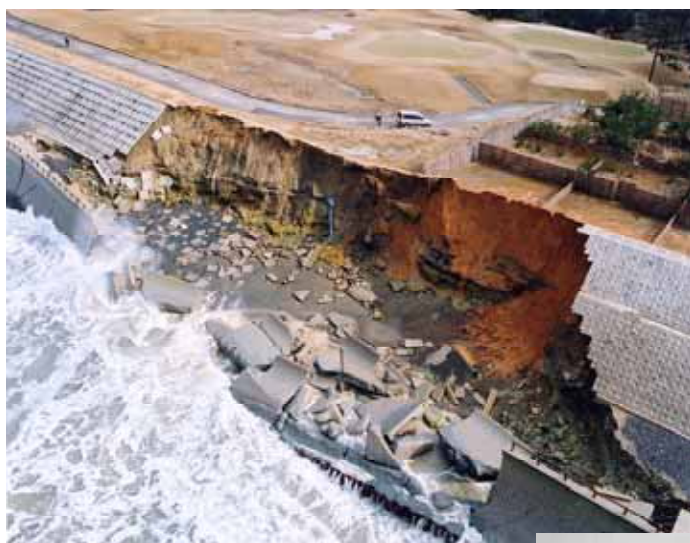
小松海岸での被災状況（平成12年1月）
