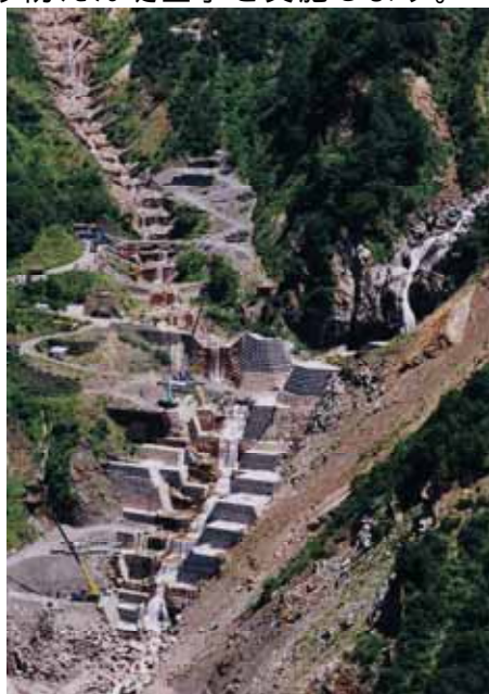
柳谷上流砂防えん堤群
