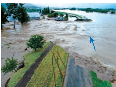
堤防決壊状況(令和元年10月13日)
