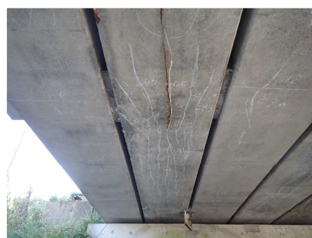
図-10 主桁の錆汁を伴うひびわれ
