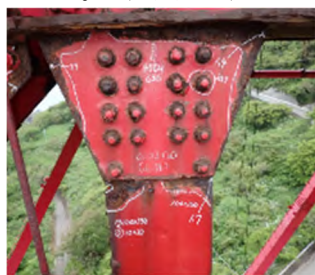
写真-5 接合部の損傷
