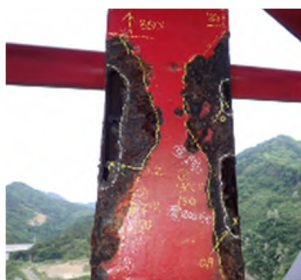
写真-6 垂直材角部の損傷
