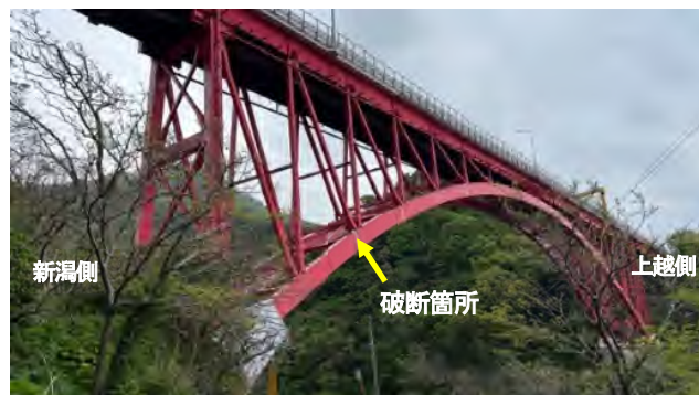
写真-2 破断箇所（海側より望む）
