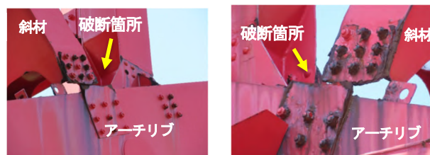
写真-3 破断したガセットプレート（左：海側 右：山側）
