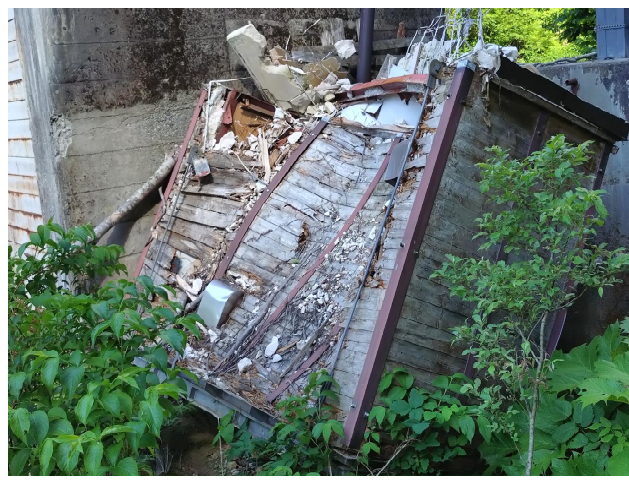
(図-3) 損壊した局舎
