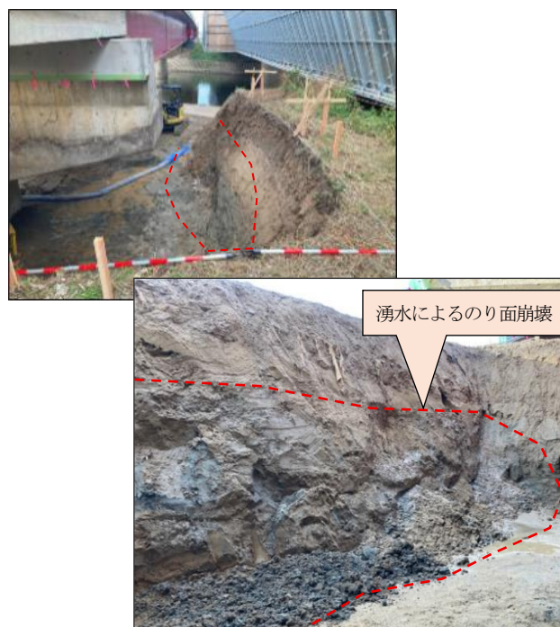
写真-2 過年度堤防開削時ののり面崩壊状況
