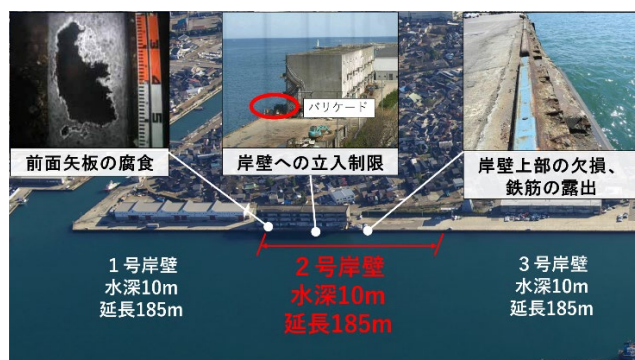
図-2 2号岸壁老朽化の状況
