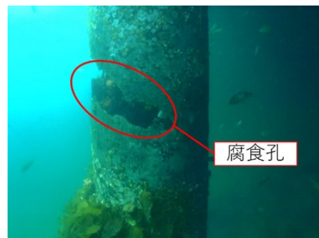
図-3 老朽化(鋼管杭の腐食)の状況
