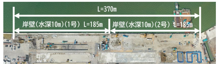
図-2 岸壁(水深10m)(戸水1号, 2号)(災害復旧)
