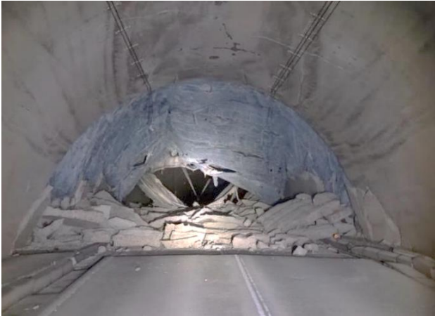
写真1 覆工コンクリート崩落状況
