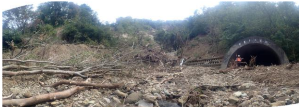
写真-7 豪雨後の輪島市街地側坑口
