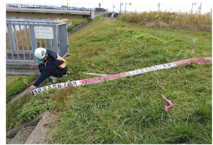
（図－5） 川表 亀裂①）
