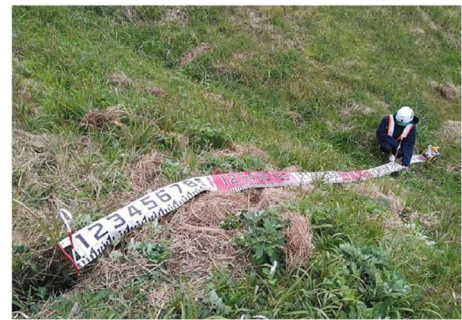
（図－7） 川裏 亀裂③）
