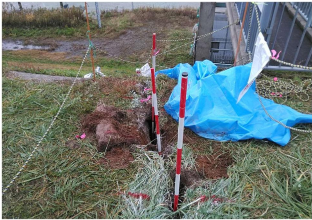
（図－3） 堤防亀裂の様子）
