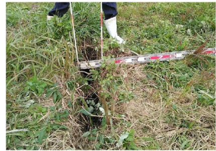
（図－6） 天端 亀裂②）
