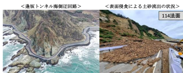
図-3 逢坂トンネル海側迂回路と土砂流出の状況
