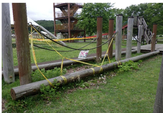
写真-3 老朽化で使用禁止となっている遊具
