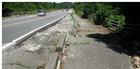
写真-1 路面被災状況
