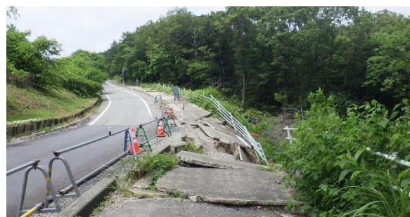
写真-2 法面崩落状況
