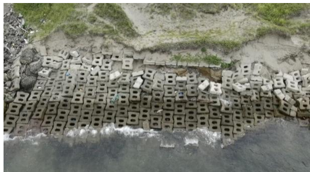
写真-7 被災箇所の上空写真 (ANAFI Ai にて撮影)
