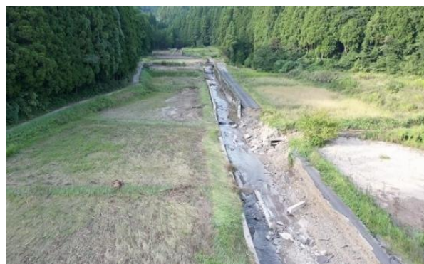
写真-2 UAVにより撮影した被災箇所の上空写真
