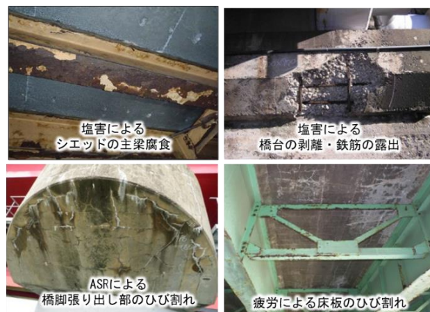
写真-4 北陸における道路施設の損傷事例
