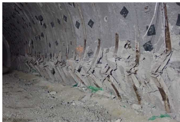
写真－2 変状した支保工
