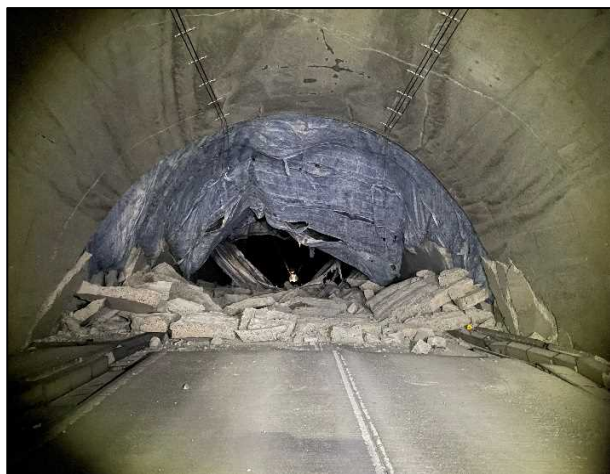
写真－1 覆工の崩落
