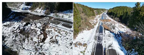
図-5 穴水道路 14.1kp における被災状況
