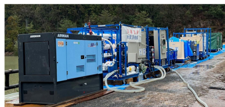
写真-2 亀ヶ谷池（かめんたいけ）に設置した可搬式給水装置 6)
