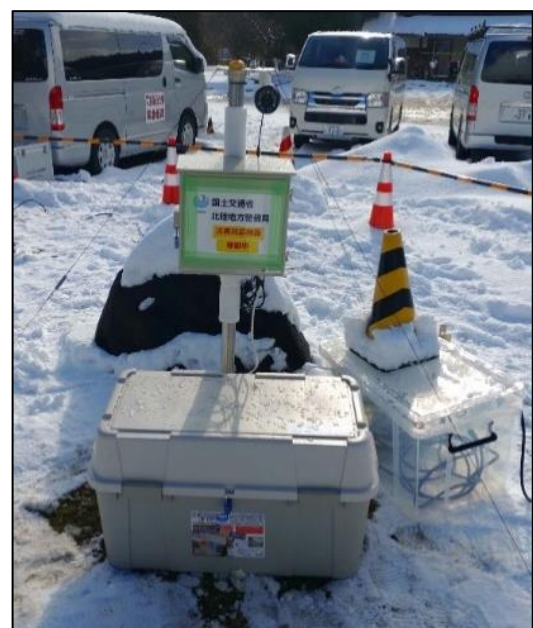
図-11 Webカメラ設置状況
