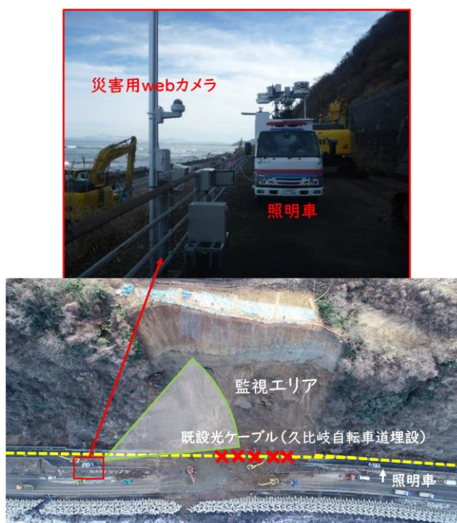
図-12 国道 8 号光ケーブル被災状況
