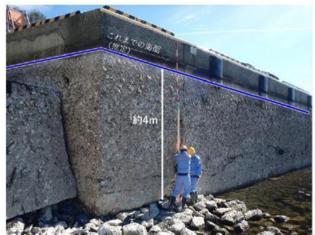
図-2 地震により隆起した現地の様子
