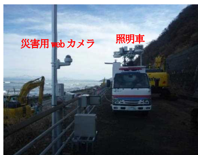
写真-3 WEBカメラ設置状況
