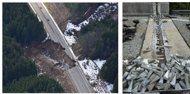
図-5 能越自動車道の大規模な盛土崩落（左）、 橋梁鋼製フィンガージョイントの破断（右）
