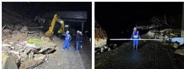
図-4 電線を巻き込んだ落石撤去方針の判断（左） 道路啓開幅員約4mの確認（右）
