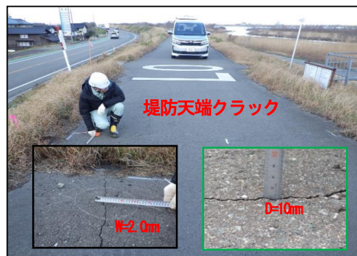
写真⑦ 堤防天端舗装の横断方向クラック
