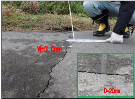
写真⑧ 高水敷坂路の横断方向クラック
