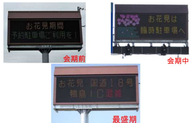
写真-4 道路情報板の表示内容
