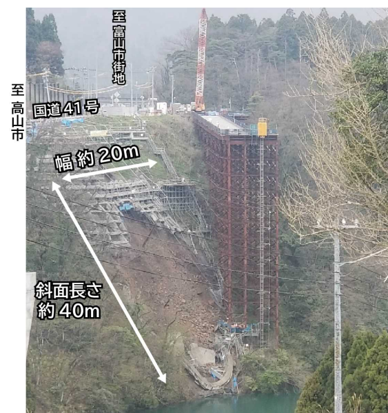
写真-1 被災状況写真(2020年4月10日対岸より)
