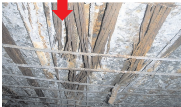
写真-2 A1～P1 側径間の破断状況
