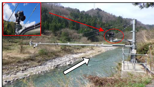
図-10 電波式流速計設置状況
