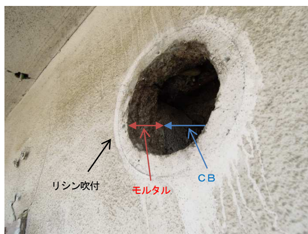
写真-2 モルタルとCBの断面状況（煙突穴）
