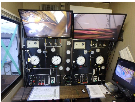
写真6 ガスコントロールパネル
