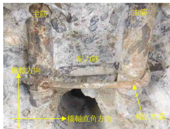
写真-3 100年経過した鉄筋の状態 (中央)
