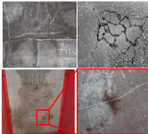
写真-1 損傷状況(上:長岡大橋 下:新境橋)
