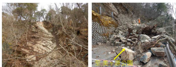
写真-2 斜面上部（左） 道路閉塞状況（右）
