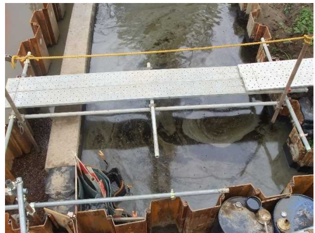
写真-3 検出された油分
