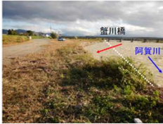
洪水の勢いで高水敷が浸食を受ける
