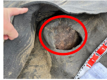
図-10 防砂シートの破れ
