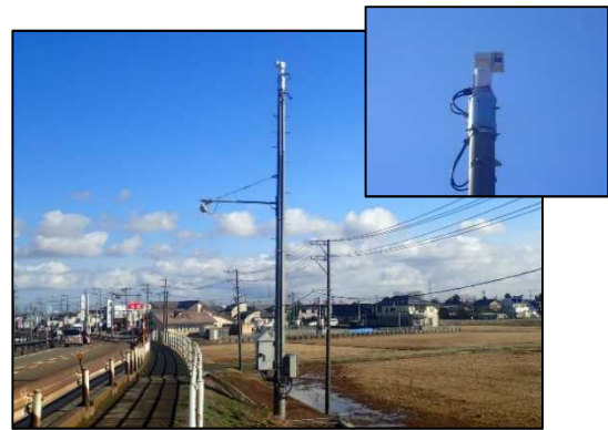
写真-2 CCTVカメラ設置状況
