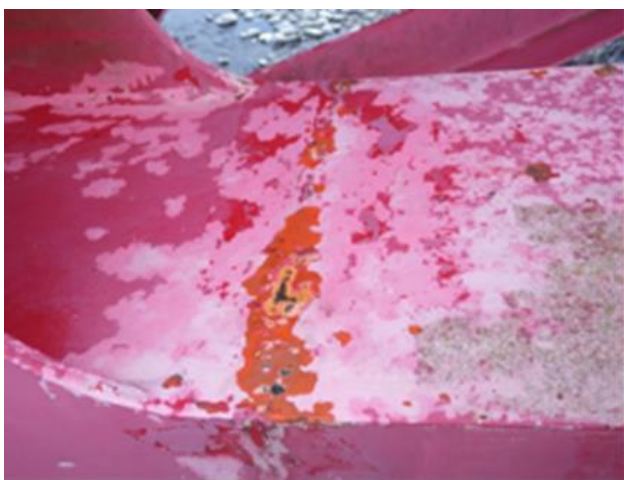
写真2 トラス部腐食状況
