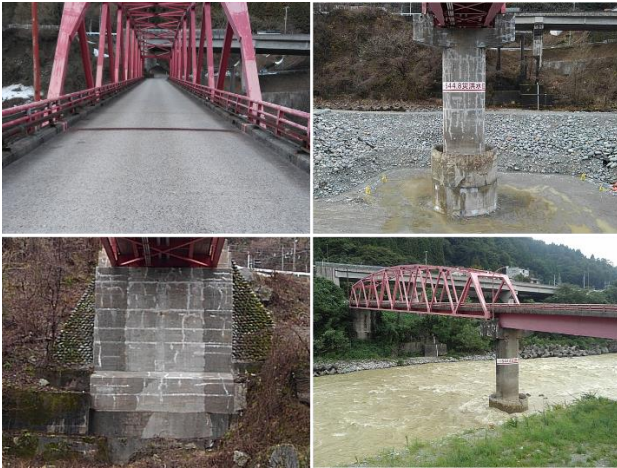
写真-7 着工前音沢橋 (左上：舗装，右上：橋脚，左下：橋台，右下：根固め)
