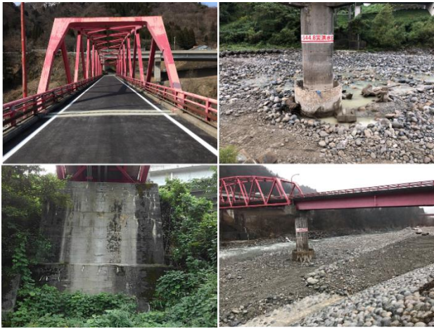
写真-8 着工後音沢橋 (左上：舗装，右上：橋脚，左下：橋台，右下：根固め)
