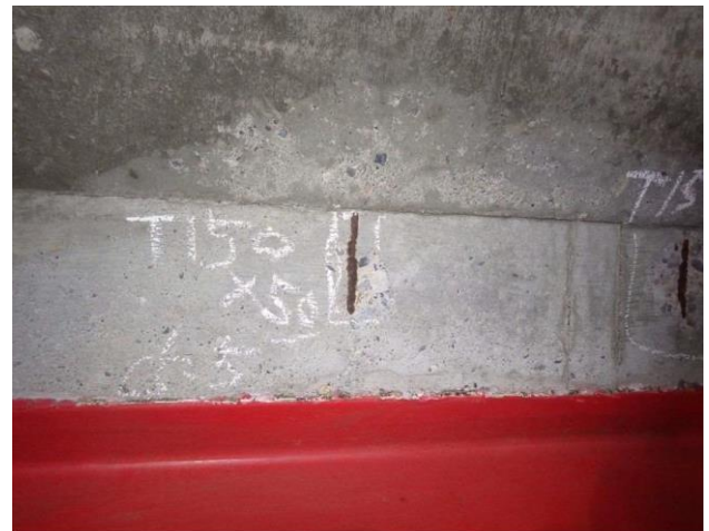
写真3 桁端部鉄筋露出状況
