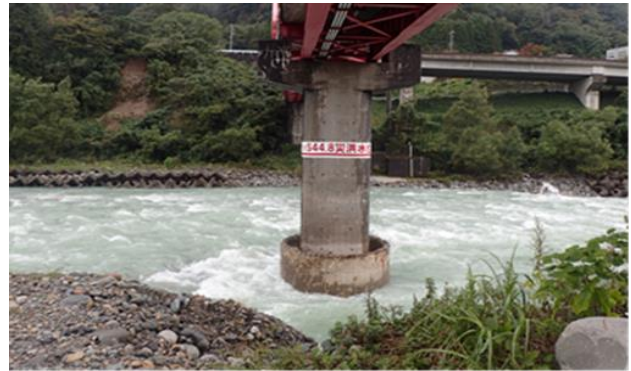
写真5 橋脚洗掘状況
