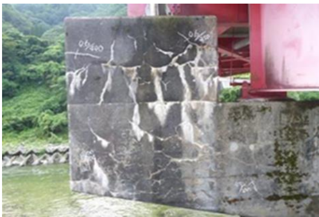
写真4 橋脚損傷状況
