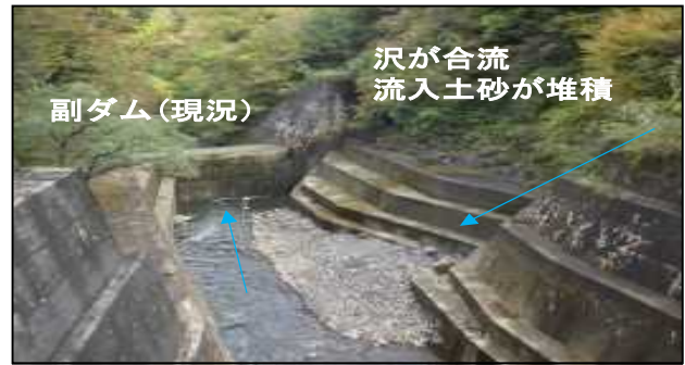
写真-8 土砂の流入・堆積状況
