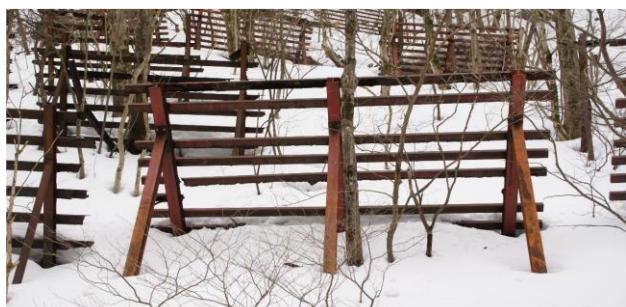
図-13 複数の横バーが不連続に欠落した雪崩予防柵
