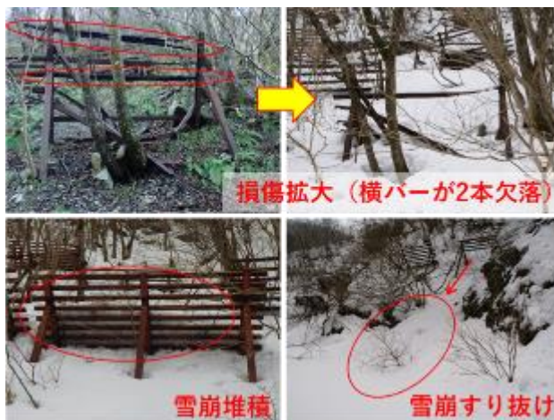
図-8 無雪期から積雪期にかけて生じた変状
