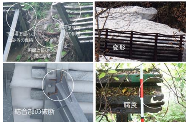
図-1 雪崩対策施設で見られる変状の例
