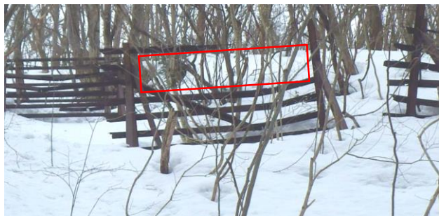
図-11 上部の横バーが複数欠落した雪崩予防柵
