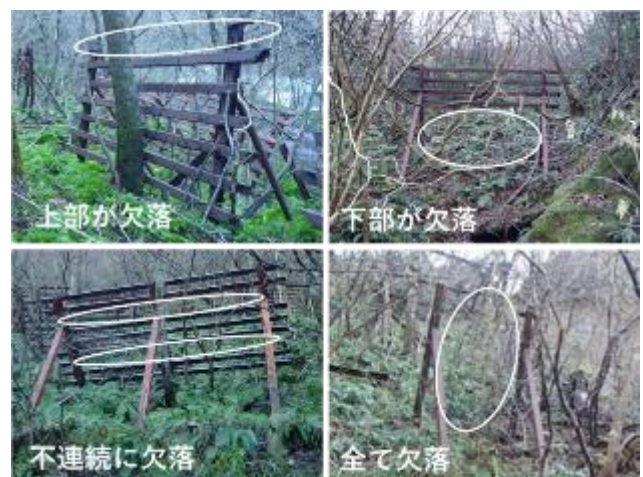
図-6 異なる箇所の横バーに変状が見られた雪崩予防柵
