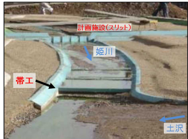
図-7 遊砂地下流地点の洗掘状況（スリット砂防堰堤）
